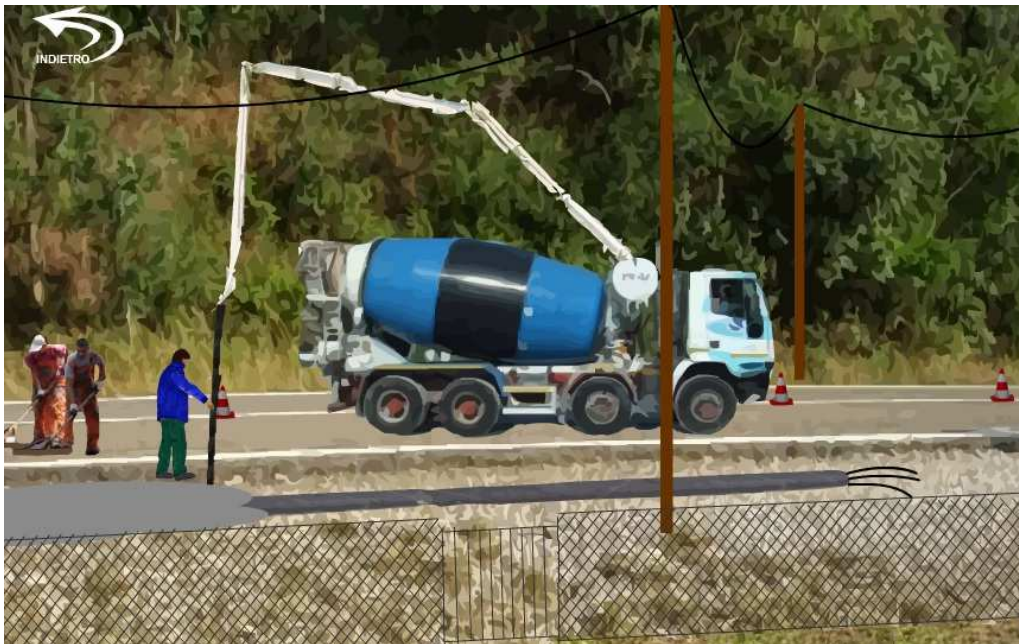
Fig.1 4.2.8- Scena dell'Infortunio: In questa immagine è riportata la scena dell'infortunio e l'utilizzo della proboscide della betoniera da parte dell'Operaio. Come si può notare dalla riproduzione dello scenario, si ha una mancanza di supervisione e la mancata presenza dei cartelli che indicano il pericolo di folgorazione.
