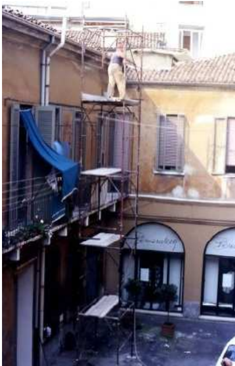
Esempio di Ponteggio incompleto
